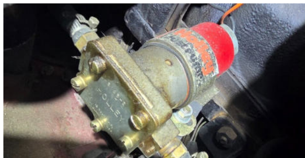
Pompe à carburant électrique installée
